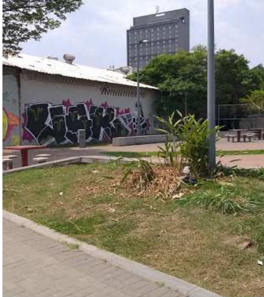
Vista dos fundos do imóvel em que é possível observar objetos deixados no telhado que é acessado por pessoas em situação de rua que provavelmente escalam a árvore na imagem.
